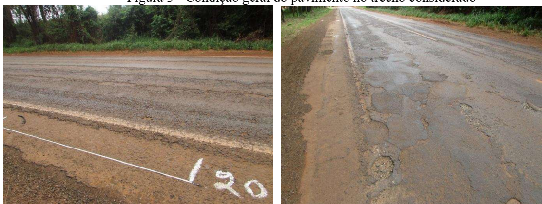
Figura 3 - Condição geral do pavimento no trecho considerado
