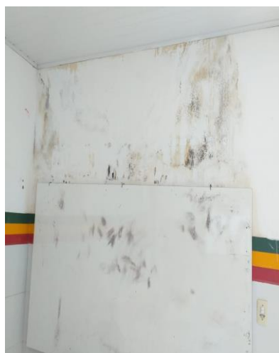
Figura 7 - Manchas na parede.
