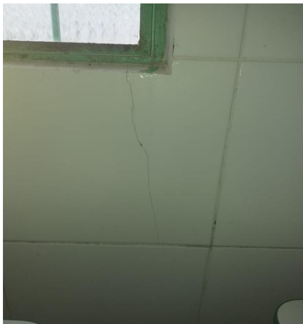
Figura 9 - Fissuras no canto inferior da janela.
