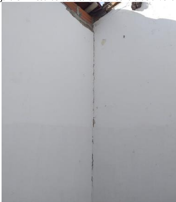
Figura 8 - Fissuras verticais no encontro de alvenarias.
