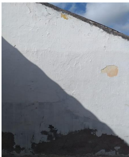
Figura 5 - Destacamento da pintura da parede exterior do banheiro.
