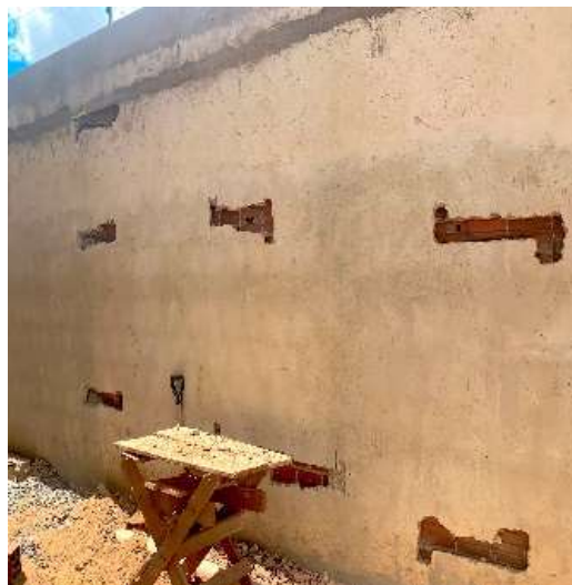
Figura 5 - Amarração em “Z” na fissura mapeada
