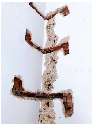
Figura 4 - Amarração em “Z” na fissura geométrica.
