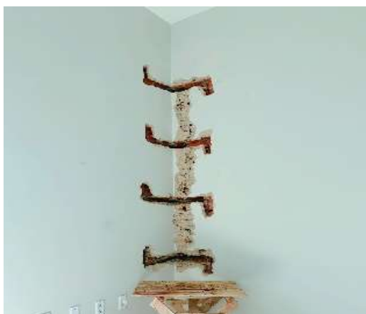
Figura 3 - Amarração em “Z” na fissura geométrica
