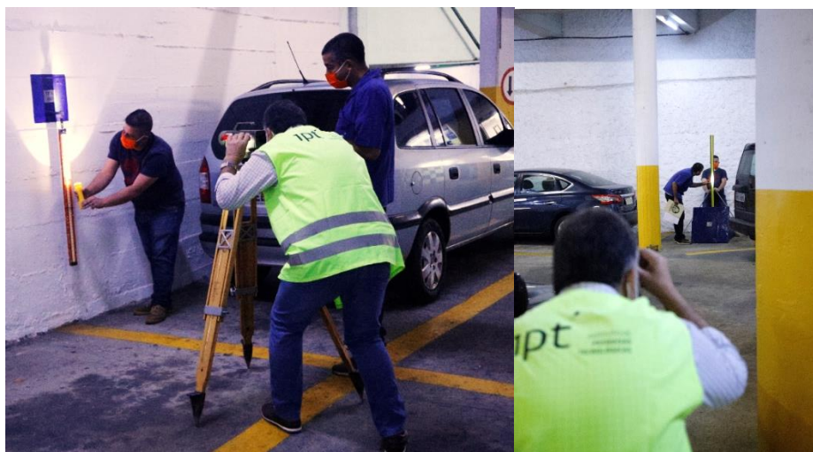
Figura 1 – Medição dos recalques.
