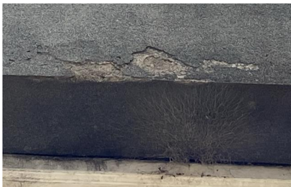
Figura 20 - Umidade por infiltração - Edificação 02 “7-815”
