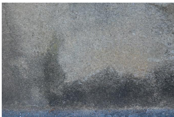
Figura 9 - Umidade no embasamento - Edificação 01 “194-1644”
