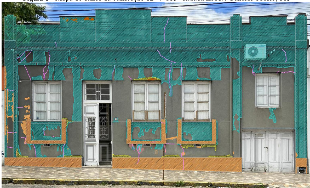
Figura 8 - Mapa de danos da edificação 02 “7-815” situada na Av. General Osório, 815
