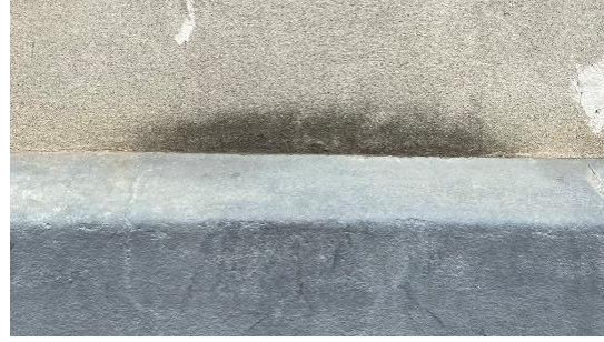
Figura 12 - Mancha por mofo, fungo e bolor - Edificação 02 “7-815”
