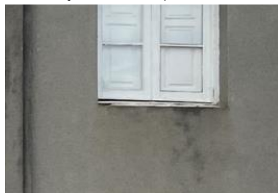
Figura 10 - Umidade na parte inferior da esquadria - Edificação 02 “7-815”
