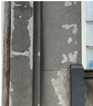
Figura 15 - Aplicação de material sem causa conhecida - Edificação 02 “7-815”
