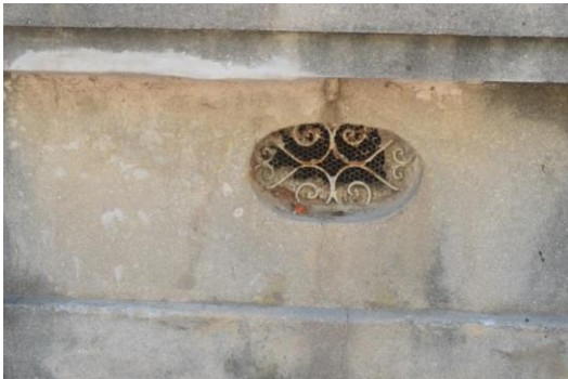
Figura 13 - Aplicação de material sem causa conhecida - Edificação 01 “194-1644”
