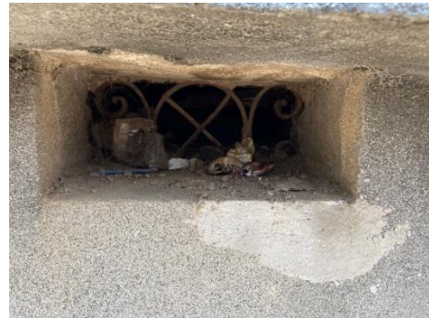
Figura 14 - Aplicação de material sem causa conhecida - Edificação 02 “7-815”
