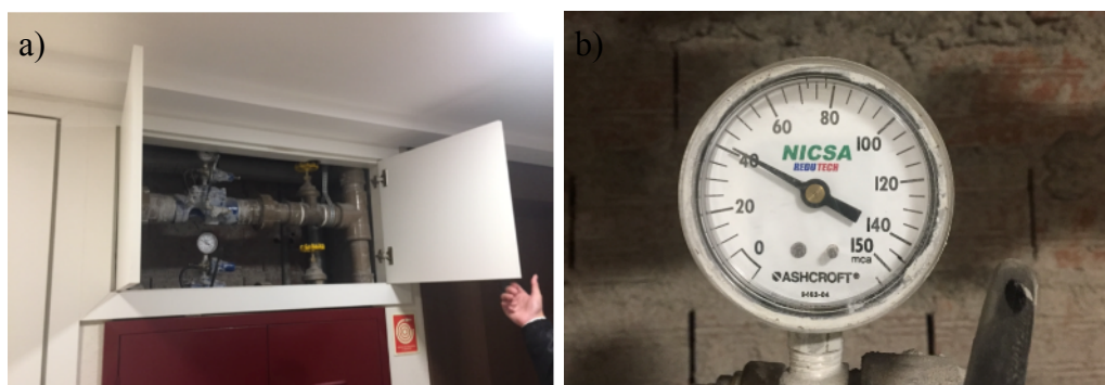
Figura 5 - a) Localização da válvula redutora de pressão; b) pressão registrada pelos manômetros das VRP no 15o. pavimento
