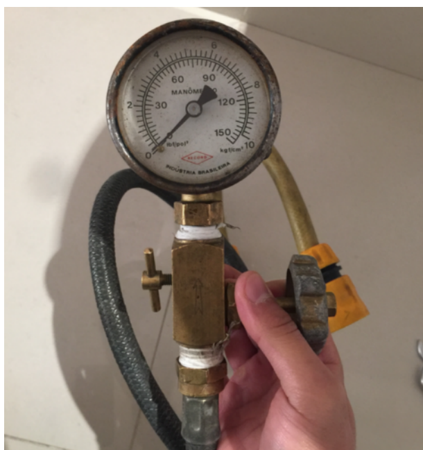
Figura 6 - Manômetro de aferição de pressão estática local
