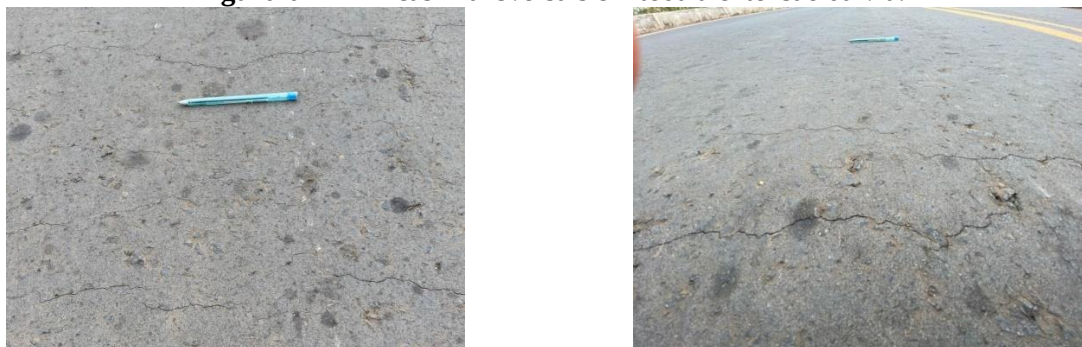
Figura 02 – Trincas Transversais em toda a extensão da via.
