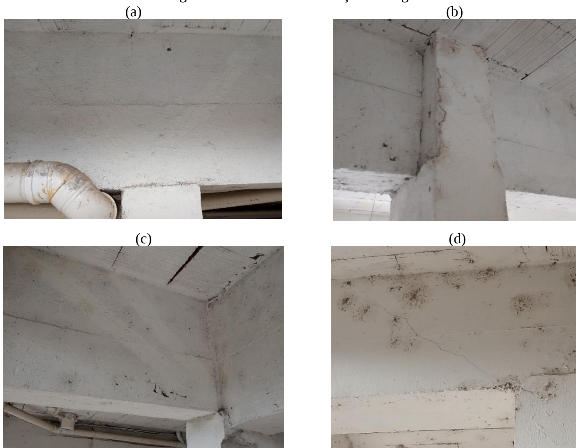
Figura 3. Panorama de fissuração das vigas.
