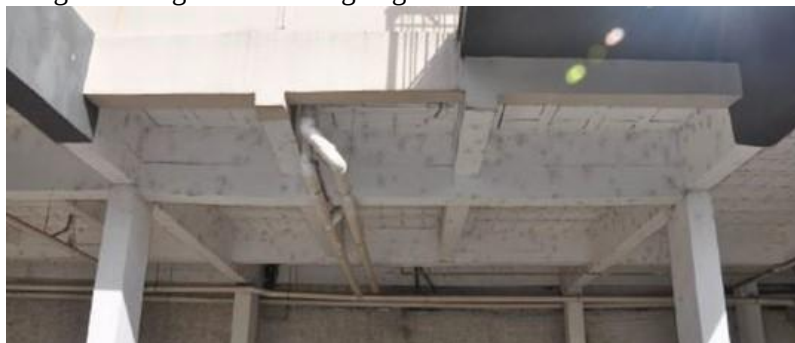
Figura 4. Vigas do teto da garagem com deslocamentos visíveis.
