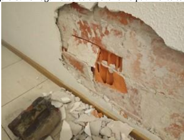
Figura 5. Esmagamento da alvenaria no pavimento térreo.
