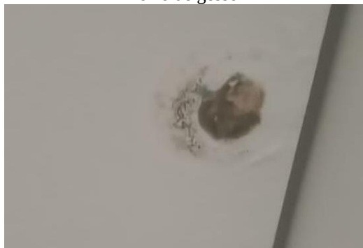
Figura 5 - Manifestação de umidade no sistema de forro de gesso
