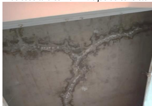
Figura 6 - Infiltração de água em fissuras da laje de cobertura com a lixiviação do concreto
