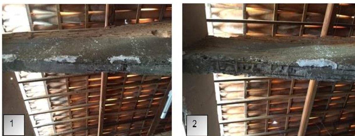
Figura 5 - Corrosão de armaduras em vigas
