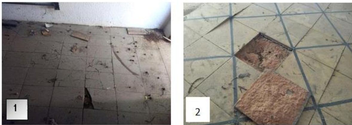
Figura 7 – Fissuração e desagregação de revestimento de piso
