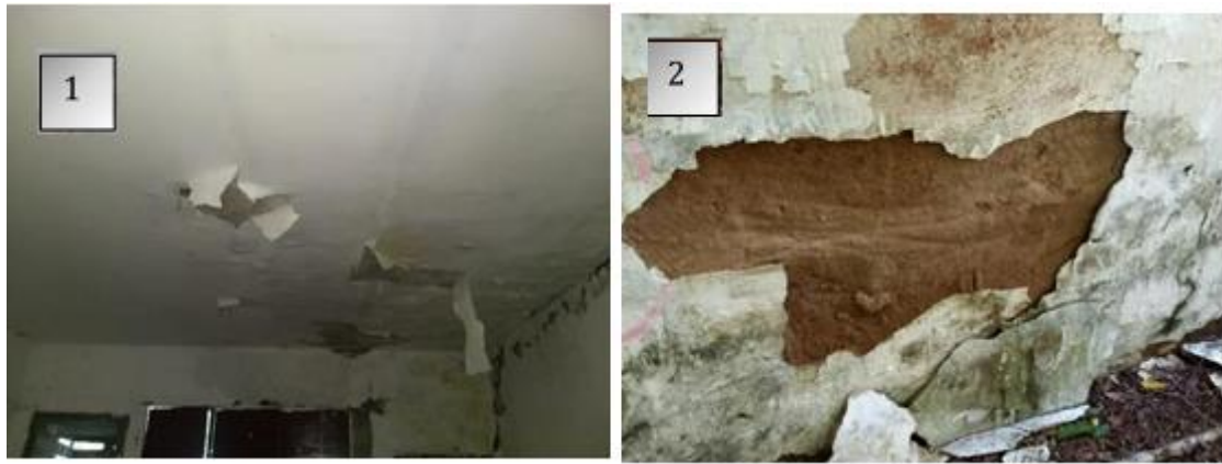
Figura 6 – Manchas em paredes e forro
