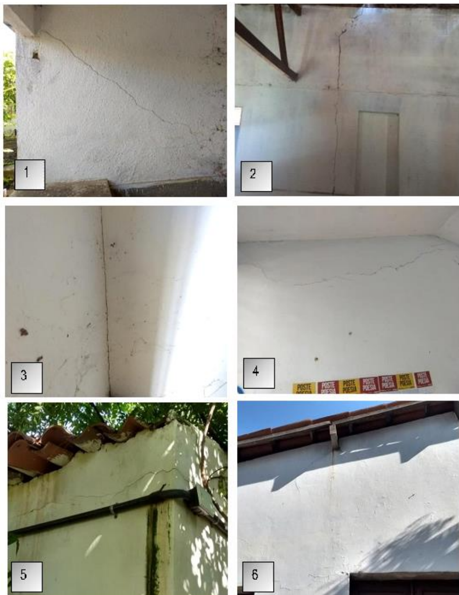
Figura 2 - Trincas e fissuras em alvenarias
