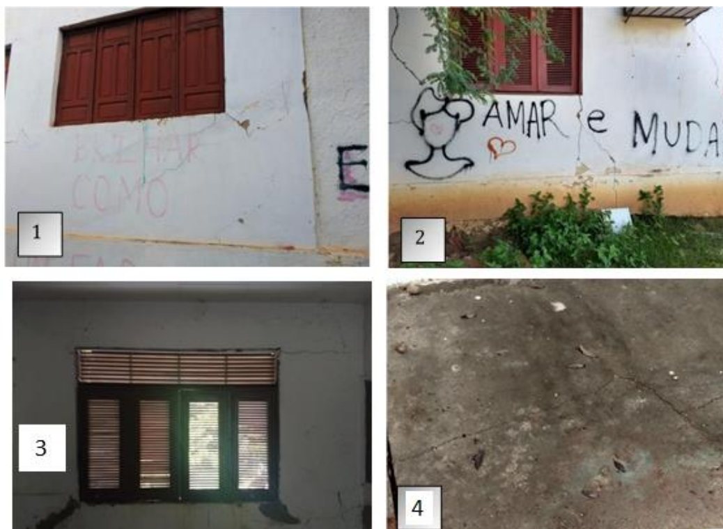
Figura 3 - Fissuras em vãos de esquadrias
