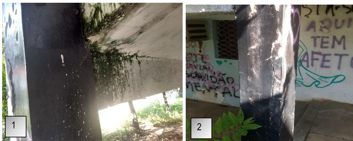
Figura 4- Fissuras e trincas em pilares
