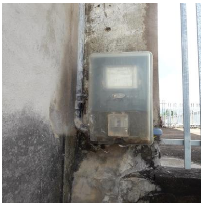
Figura 5: Quadro de medição da empresa de distribuição B-20.
