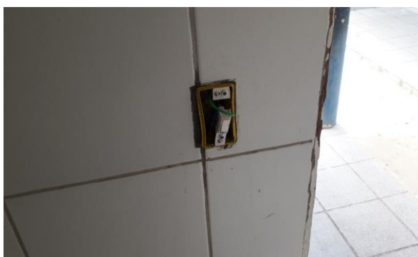
Figura 4: interruptor da iluminação do banheiro B-14.
