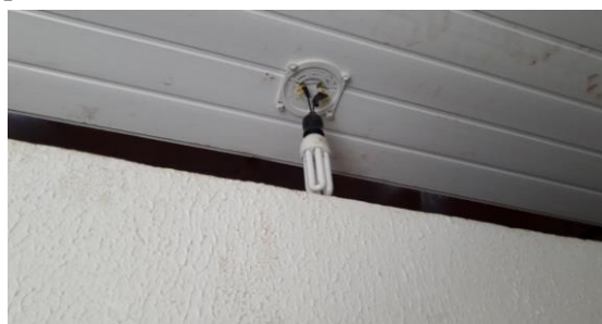
Figura 7: Iluminação do banheiro EJLT A-22.
