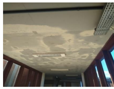
Figura 8 – Eflorescência e manchas.
