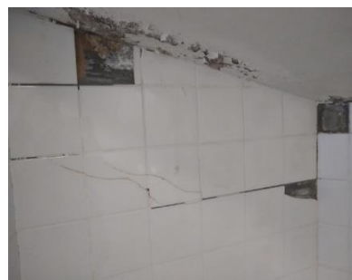
Figura 6 – Destacamento da cerâmica.
