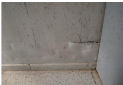
Figura 7 – Bolhas e desagregamento.
