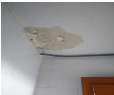
Figura 5 – Saponificação e manchas por umidade acidental.
