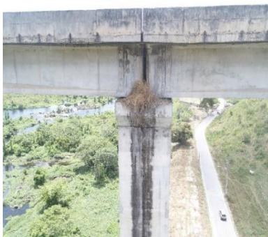
Figura 11 - Pilar 3 presença de vegetação e manchas de umidade
