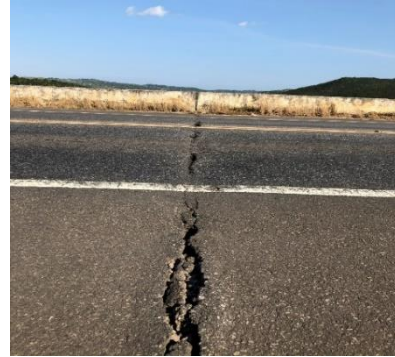
Figura 8 – Material deteriorado na superfície da junta
