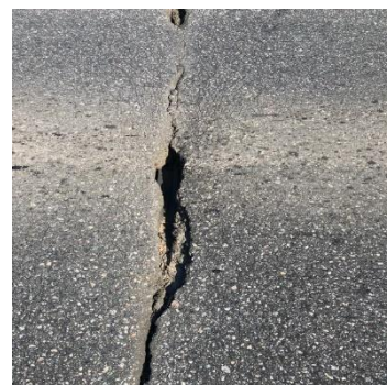
Figura 12 – Obstrução das juntas por material asfáltico
