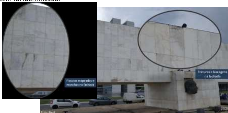
Figura 7 – Manifestações patológicas detectadas na fachada do Museu da Cidade
