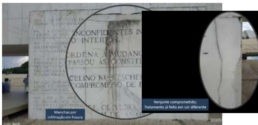
Figura 8 – Manchas por infiltração em fissura
