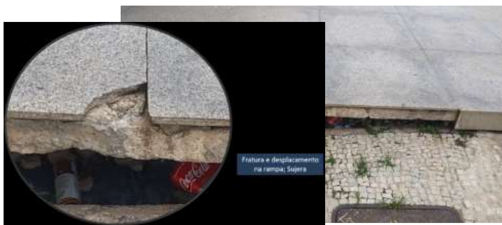
Figura 9 – Fratura e deslocamento na rampa; Sujeira
