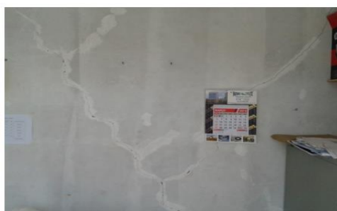
Figura 3 – Fissuras na alvenaria da recepção
