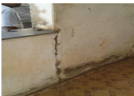
Figura 7 – Trinca vertical parapeito
