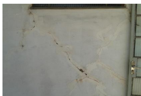
Figura 8 – Trincas em janela de banheiro
