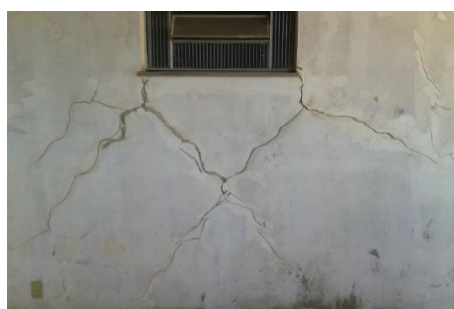
Figura 6 – Trincas em janela de banheiro
