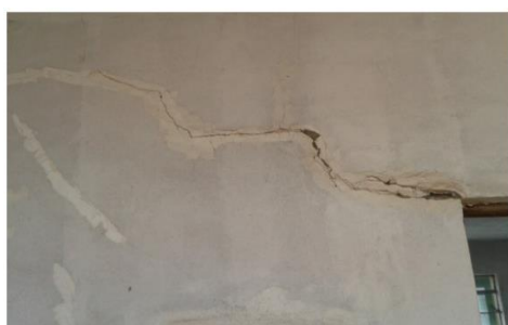
Figura 5 – Trinca sobre porta
