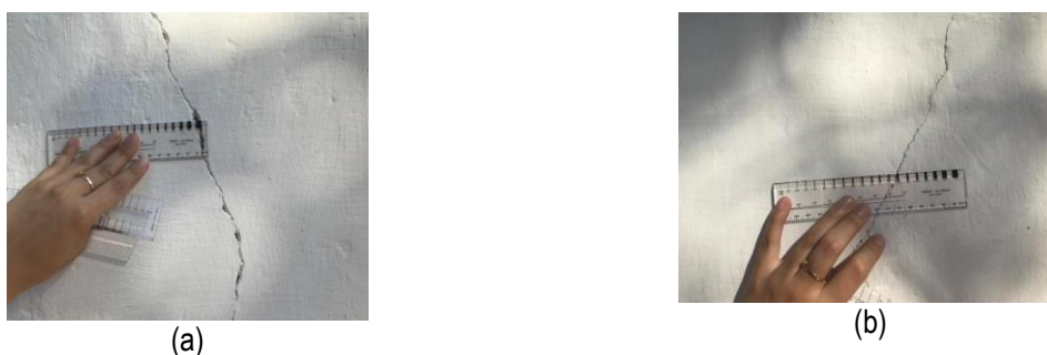
Figura 7 – Leitura das aberturas das fissuras na parede lateral esquerda (a) abertura de 7mm e (b) abertura de 1,3mm. Fonte: Fotos dos autores, 2019
