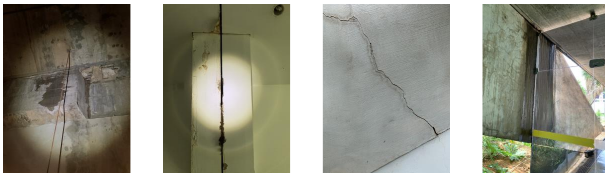
Figura 4, 5, 6 e 7 – Patologias identificadas na estrutura do Teatro Nacional
