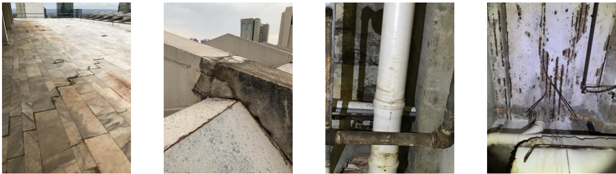
Figura 8, 9, 10 e 11 – Patologias identificadas na cobertura do Teatro Nacional
