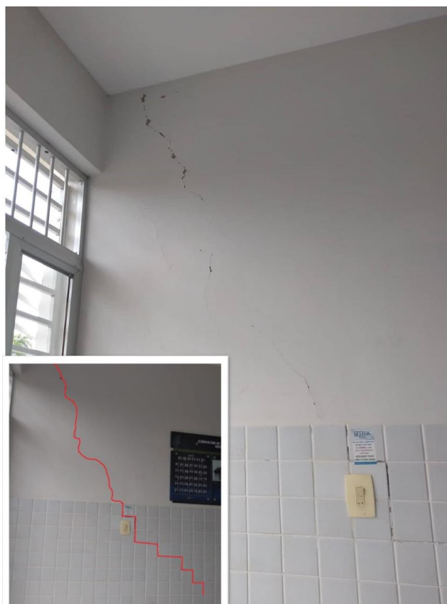
Figura 2 – Destaque da inclinação da fissura inclinada 45^\circ .
