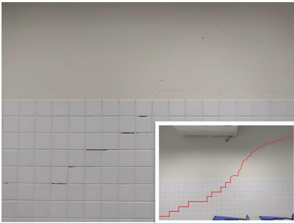
Figura 3 – Destaque da Inclinação da Fissura Bloco II de aula.
