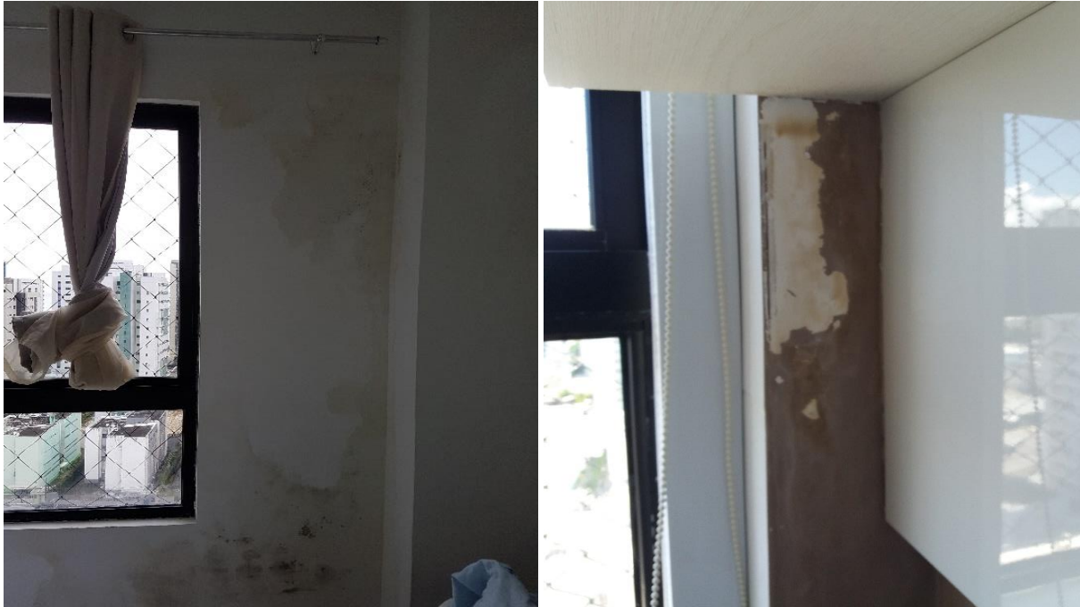
Figura 2 – Manchas ocasionadas por infiltração no apto. 1402 e destacamento de pintura em parede do apto. 1501
