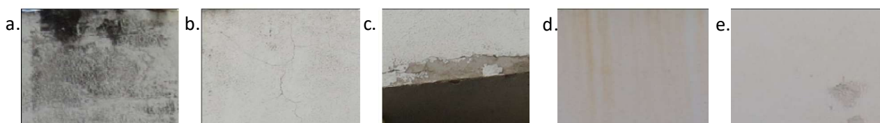
Relação entre os defeitos comuns em sistemas de revestimento em argamassa e as zonas constituintes das fachadas
