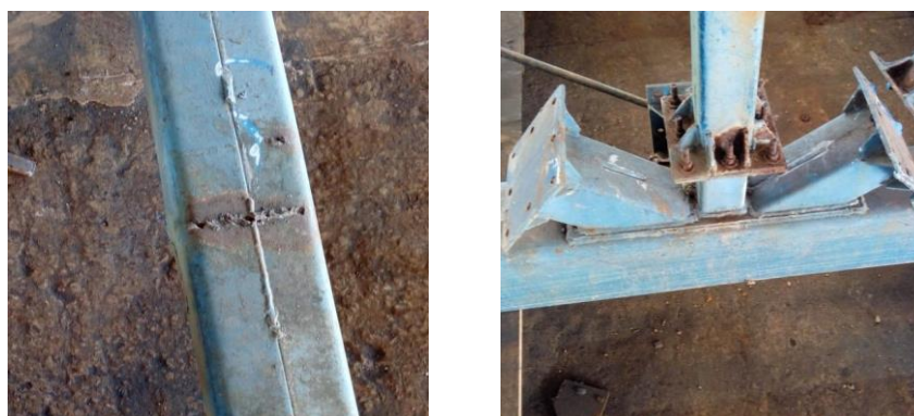
Figura 4 – À esquerda detalhe de peça onde ocorreu corrosão na solda. Observa-se a baixa qualidade da solda e ausência de acabamento. À direita parafusos de ligação em avançado estado de corrosão.
