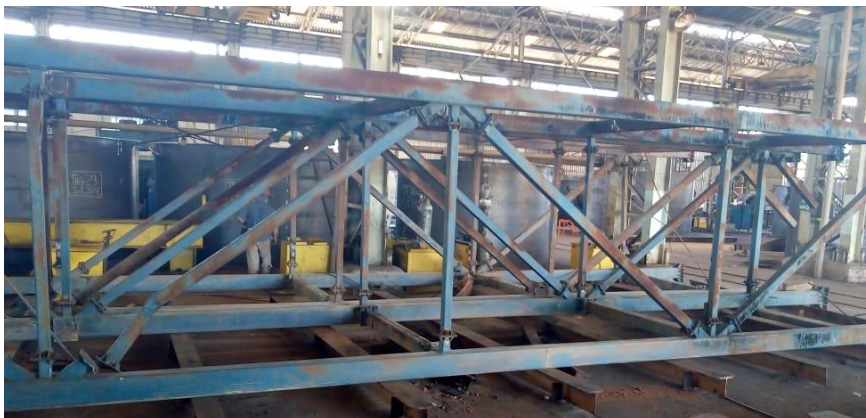
Figura 3 – Vista de parte da estrutura, com diversas regiões em avançado estado de corrosão.
