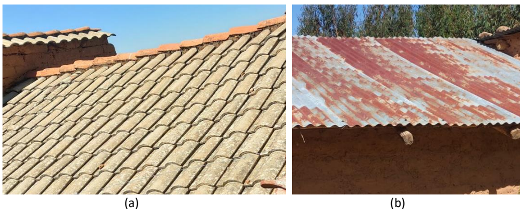
Figura 11 - Deterioro de los techos de a) teja y b) calamina
