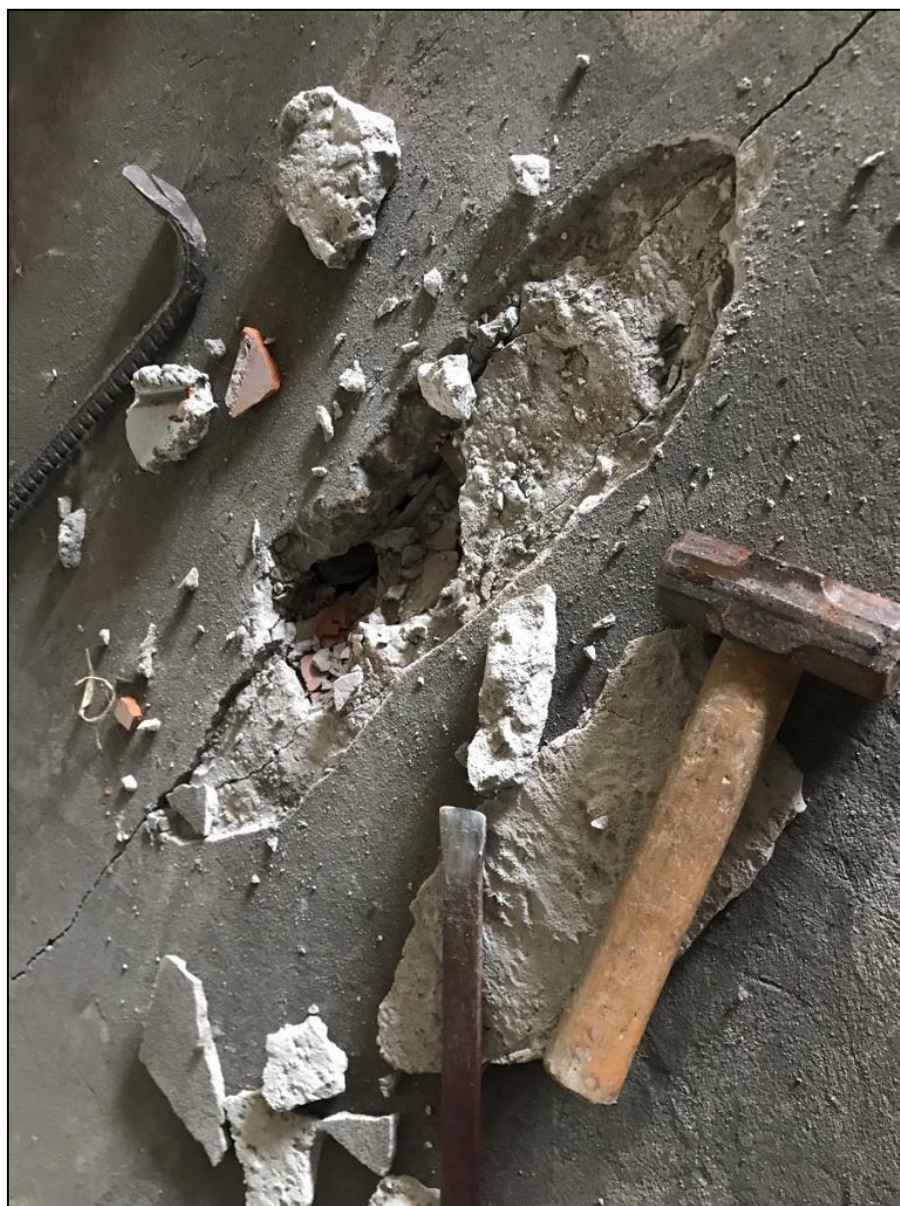
Figura 8 – Vista com maior detalhe da fissuração existente.
