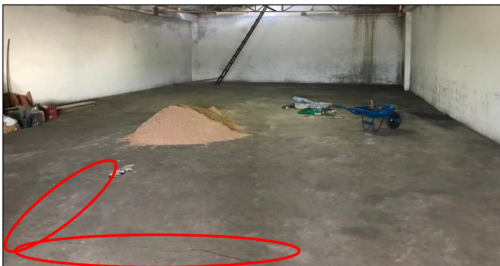
Figura 7 – Vista geral com ilustração das fissuras existentes.
