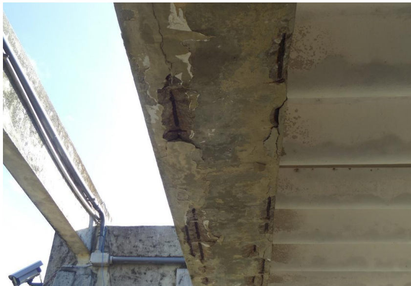
Figura 3 – Corrosão das armaduras
