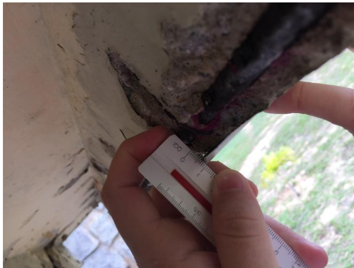
Figura 9 – Espessura do concreto carbonatado
