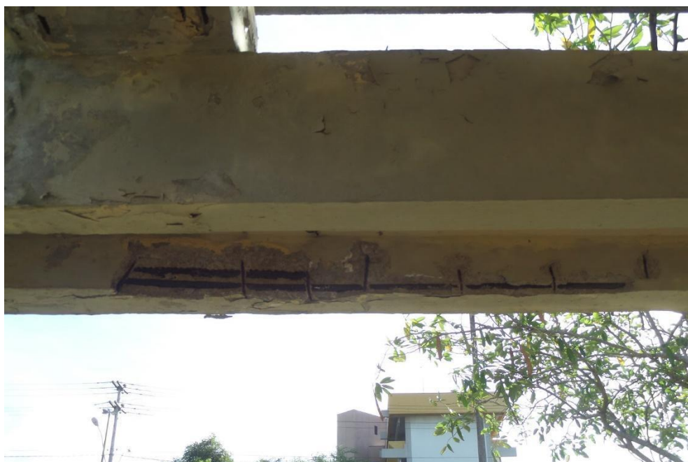
Figura 7 – Viga em situação precária
