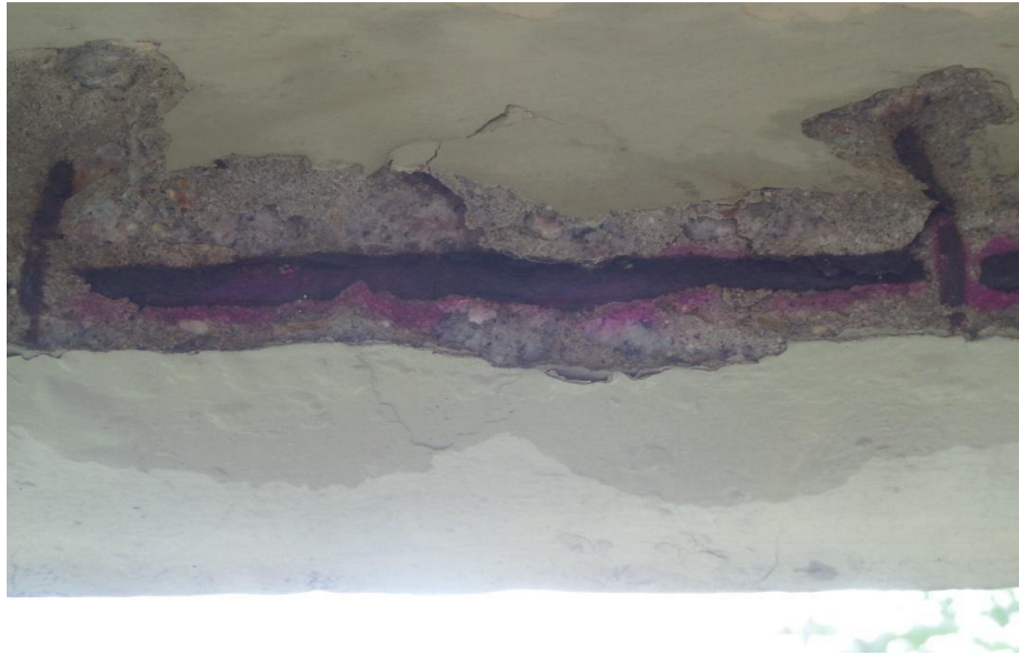
Figura 8 – Ensaio de carbonatação em um trecho da viga
