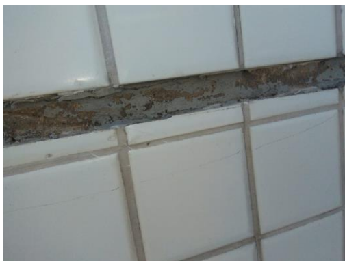
Figura 9 – Limitador de profundidade removido
