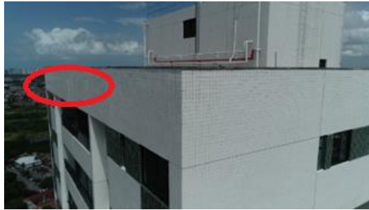
Figura 6 – Eflorescência na platibanda
