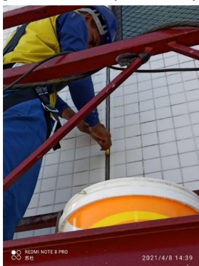
Figura 8 – Abertura de junta de dilatação
