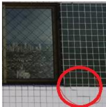
Figura 4 – Fissura inclinada característica de movimentação térmica
