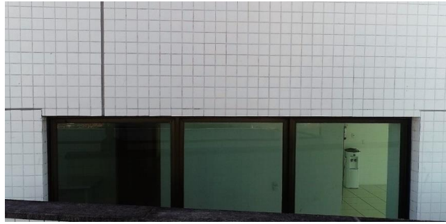
Figura 3 – Juntas de movimentação interrompidas em local não adequado
