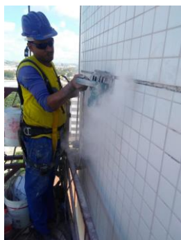
Figura 11 – Reabertura de junta de dilatação
