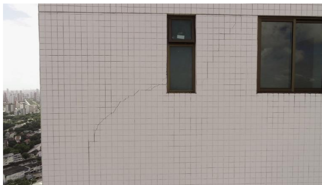
Figura 5 – Fissura inclinada, característica de efeito da movimentação térmica na laje de coberta
