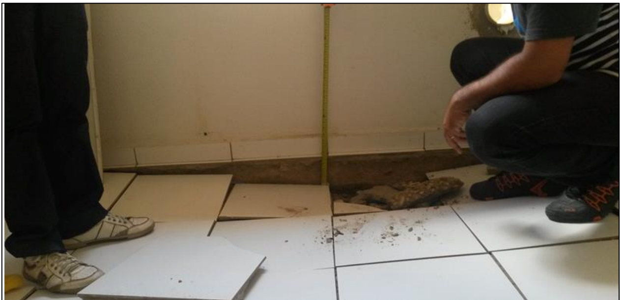
Figure 6 – Vista do abaulamento do piso.
