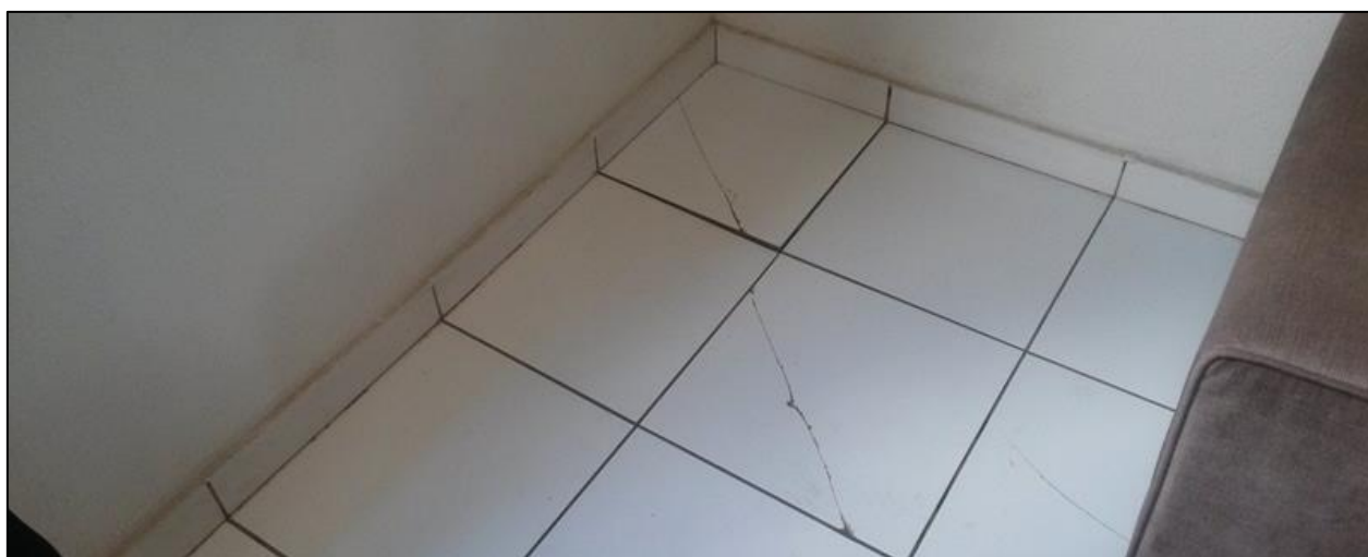
Figure 5 – Fissuração da placa cerâmica decorrente de recalque no solo.
