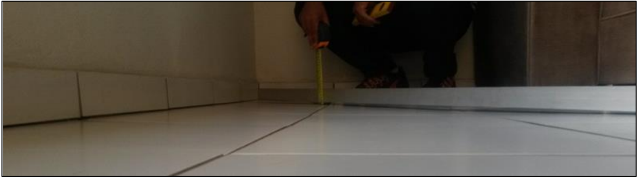
Figure 6 – Vista do abaulamento do piso.
