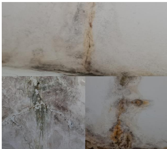
Figura 11 – Fissuras na parede e teto da UBS
