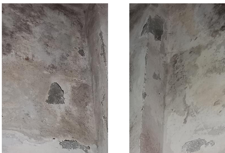
Figura 9 e 10 – Deslocamento do revestimento da parede
