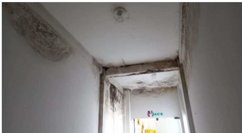
Figura 7 – Mofo e bolor nas paredes
