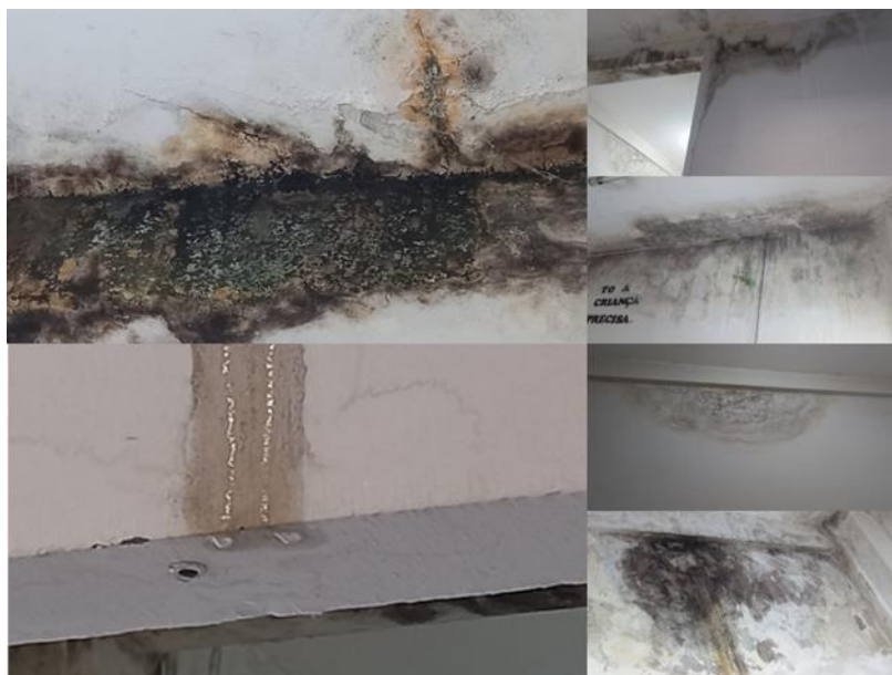
Figura 8 – Infiltrações na parede e teto do corredor
