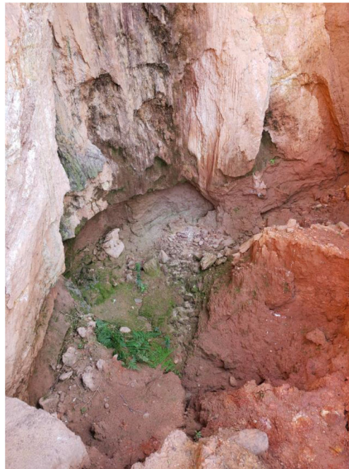
Figura 5. Detalhe do perfil de erosão no talude do Ponto 2, curva em S (Alegre, ES).
