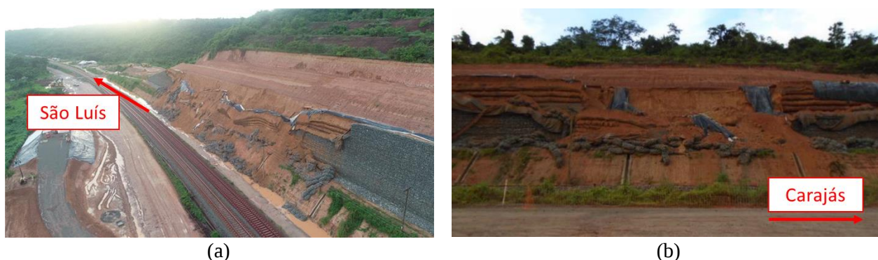
Figura 3 – Vista geral da ruptura (a) lado São Luís (b) lado Carajás (Fonte: VALE).
