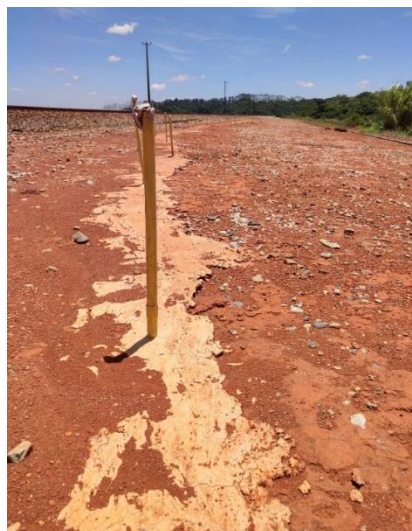
Figura 3: Trincas na plataforma ferroviária.
