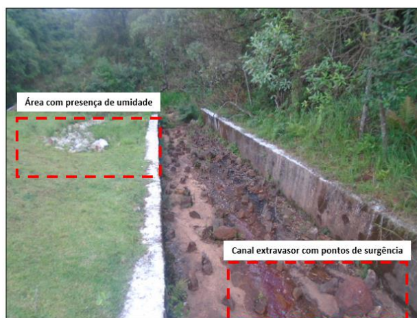
Figura 1. Local com indícios de movimentação e com presença de umidade e surgência no canal extravasor.
