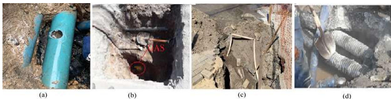
Figura 5 – Exemplos de interferências encontradas no trecho considerado crítico, Francisco de Paula, 2021.
