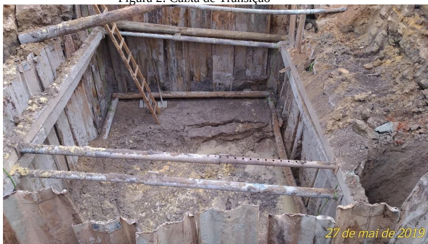
Figura 2: Caixa de Transição
