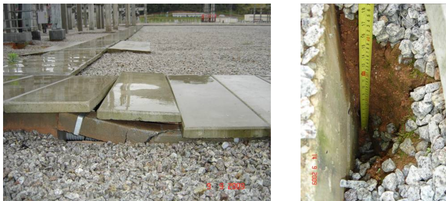
Figura 4 – Recalque diferencial na canaleta de cabos e cavidades na camada superficial.
