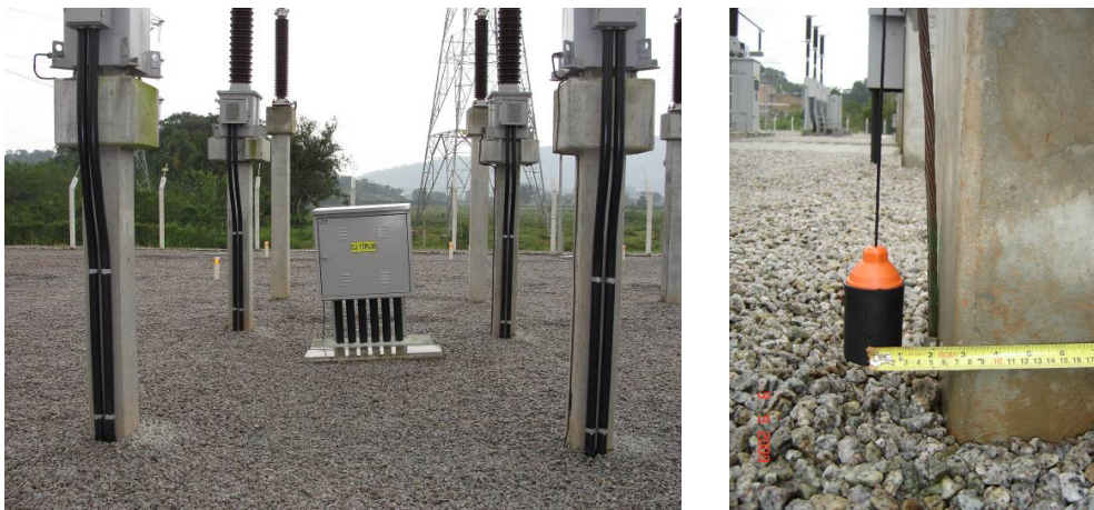
Figura 3. Recalque diferencial das bases dos armários e aferição de desaprumos em estruturas de suporte.
