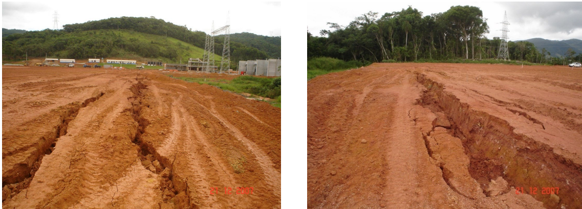
Figura 2. Ruptura do solo do aterro e da argila mole durante a terraplenagem e execução do aterro.
