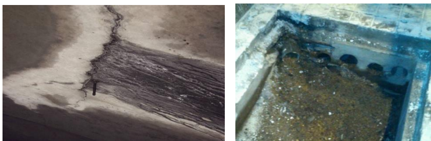
Figura 4. Aduela 28 da galeria Norte. Escorrências e depósitos ao longo de fissura situada no teto da abóbada. Caixa de inspeção colmatada, nos drenos de descarga
