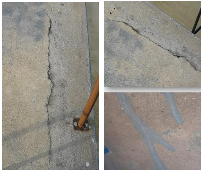
Figura 11. Fissuras nas lajes do estádio. Fonte: Autor (2020).
