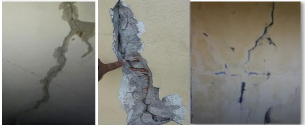
Figura 7. Vestiário dos atletas. Eflorescências e destacamento de pintura por ação de umidade mapeados. Fonte: Autor (2020).
