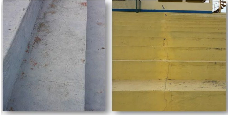
Figura 17. Fissuras mapeadas típicas de retração por secagem e juntas estruturais defeituosas ou mau executadas ao longo da arquibancada.
