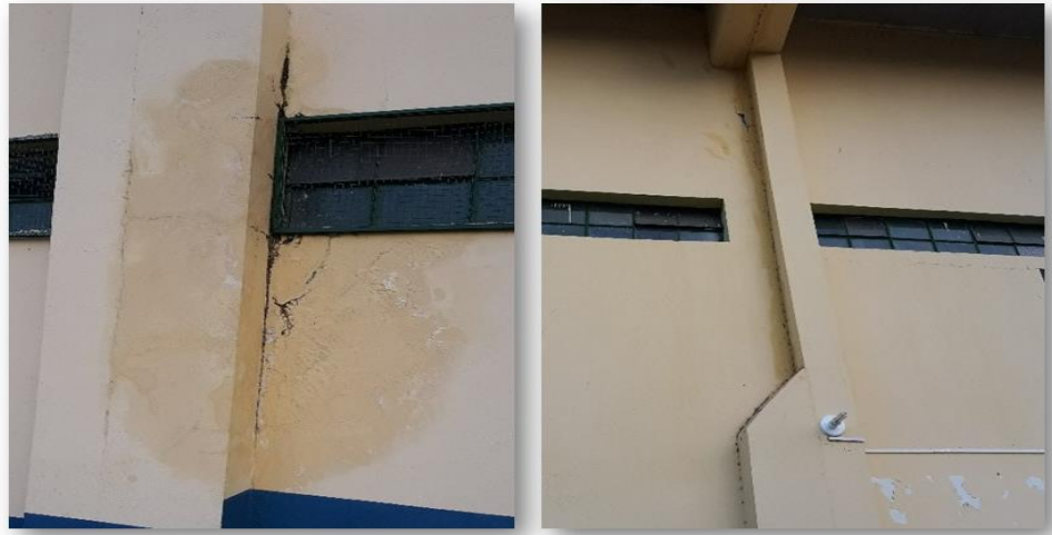
Figura 6. Manifestações patológicas localizadas na fachada. Fonte: Autor (2020).
