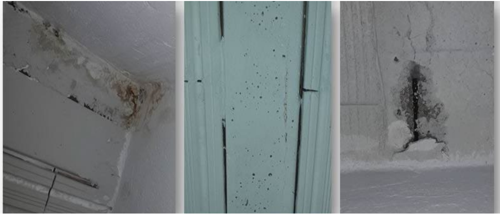
Figura 13. Fissuras, umidade nas extremidades e rachaduras com armadura exposta nas lajes do estádio. Autor: (2020).
