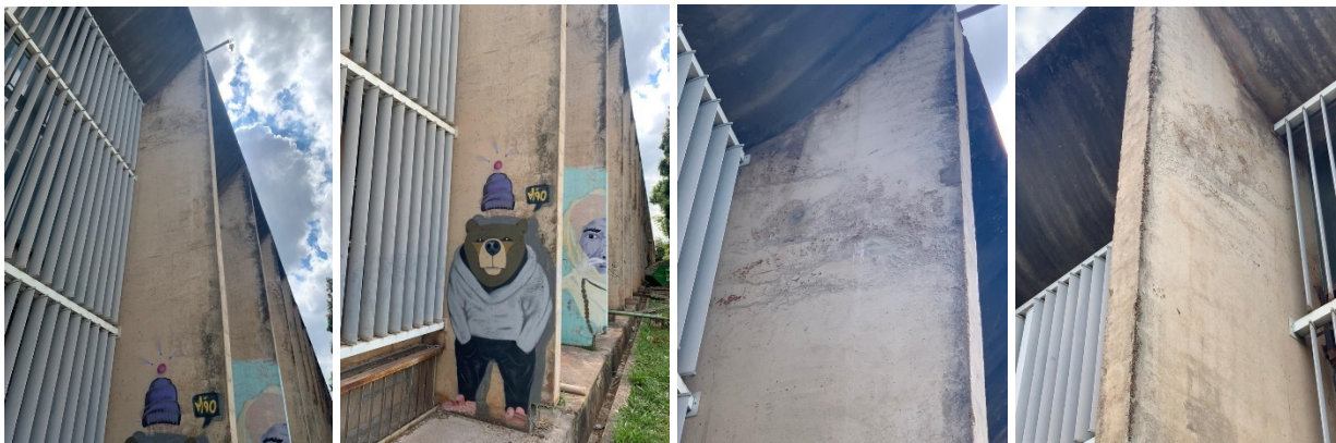
Figura 7- Pilar 8: ninho de concretagem.
