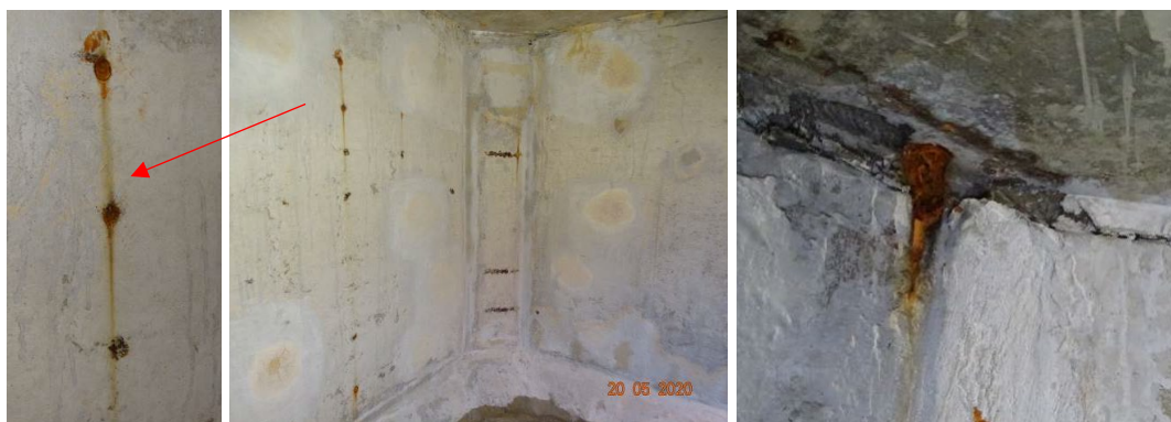
Figura 5. Exemplo de armadura aparente na mísula e de pontos de corrosão (bolhas) de arames nas vigas parede.
