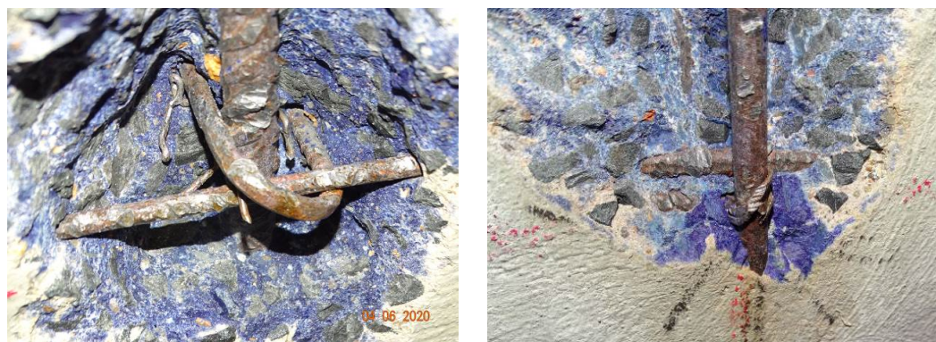
Figura 10. Detalhe do gancho da J12 e do vergalhão com cobrimento mínimo na J7, ambos com princípio de corrosão.
