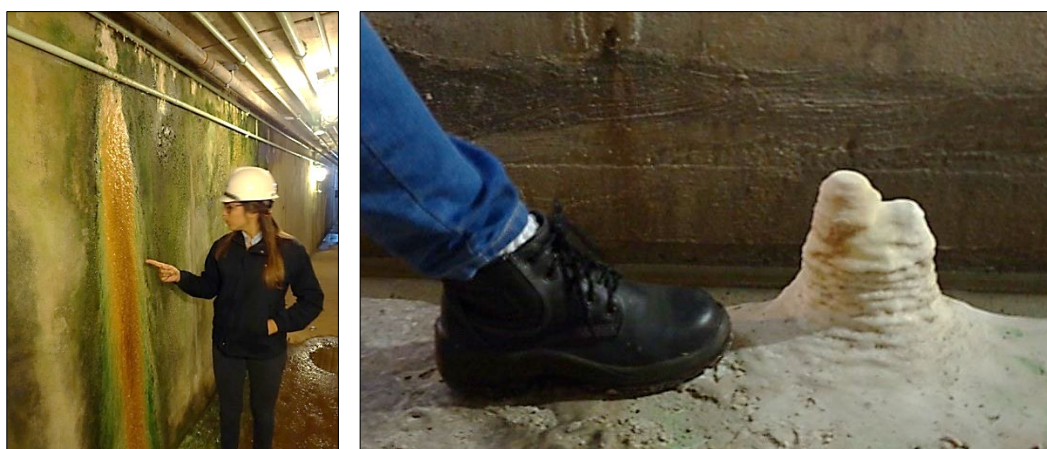
Figura 1. Exemplos de lixiviação em concreto massa na Usina Hidrelétrica (UH) de Itaipu (C. J. Neumann, 2019).
