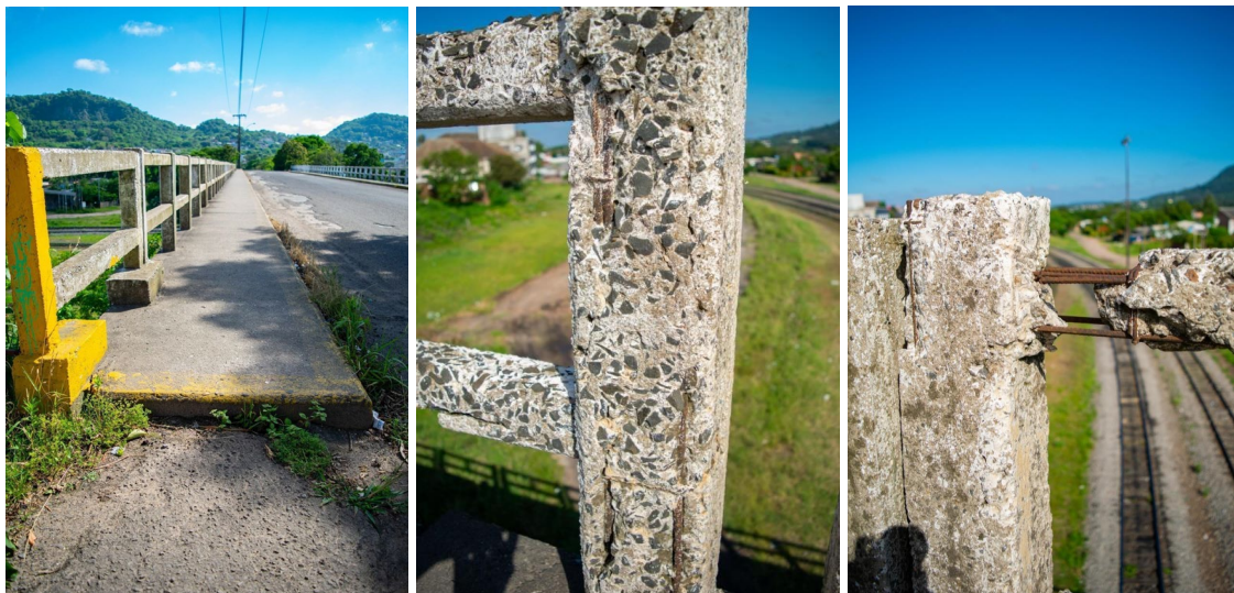
Figura 9. Detalhe dos danos no guarda-corpo.
