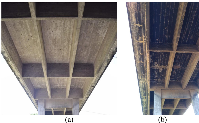
Figura 5. Tabuleiro de lajes maciças de concreto armado, travessas, longarinas e transversinas que compõem a estrutura do viaduto.
