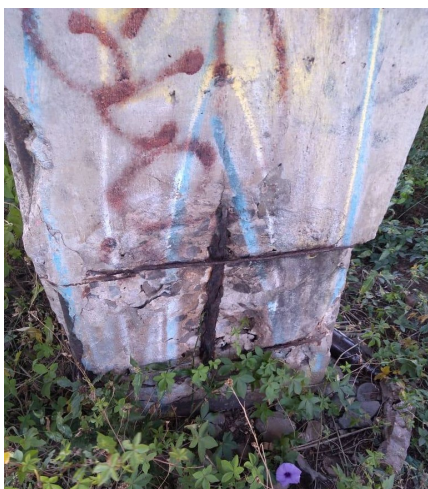
Figura 6. Pilar 5 com armaduras expostas.
