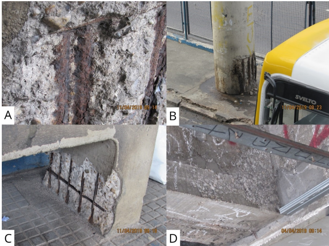
Figura 4. A: No T4, base de pilar com armadura exposta em estágio avançado de oxidação; B: No T4, base de pilar de passarela com armadura exposta em alto grau de corrosão; C: Base de assento de concreto deslocada e com armadura exposta no T4; D: Viga no T3 apresentando ninhos de concretagem gerados na execução do elemento estrutural.
