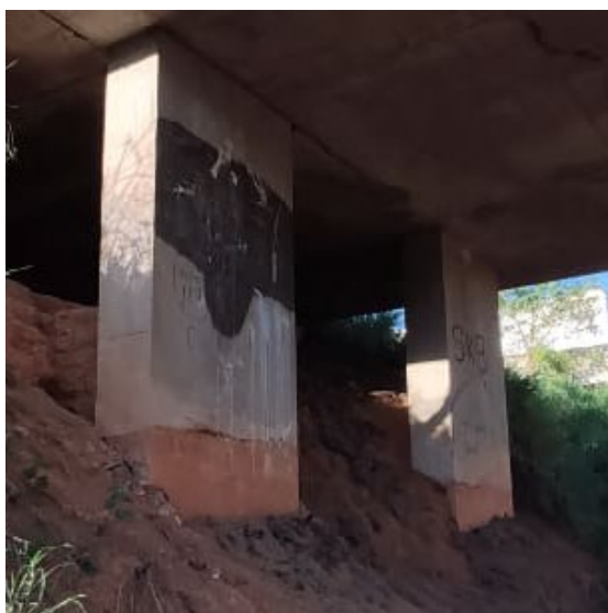
Figura 5. Pilares Calcinação do concreto.
