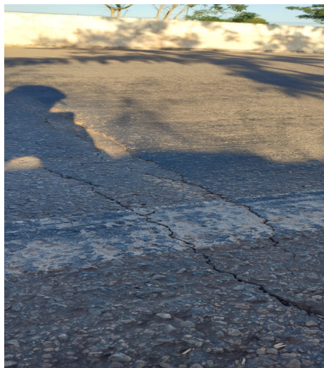
Figura 3. Fissuras no encontro com o pavimento.
