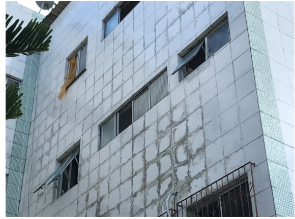
Figura 6 - Carbonatação na área dos rejantes
