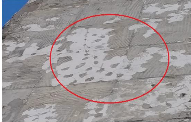
Figura 10 - Argamassa Colante Sobre Pintura
