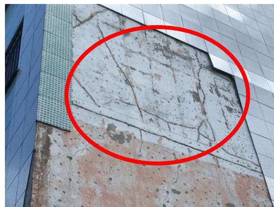
Figura 4 - Área de Fissurações
