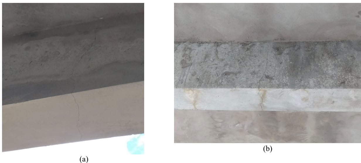
Figura 7. Fissura localizada na viga (a) e (b).
