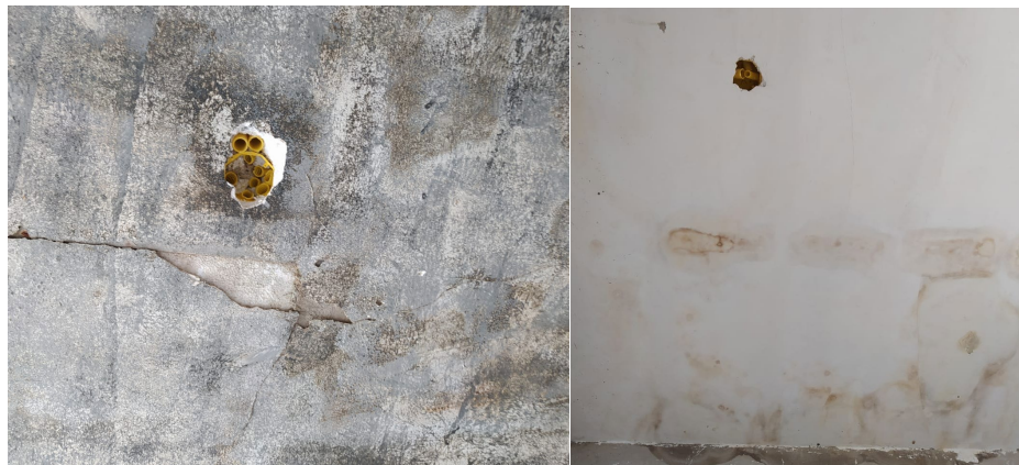
Figura 11. Laje com sinais de umidade e bolor, descascamento do revestimento e detalhe da caixa de passagem elétrica.
