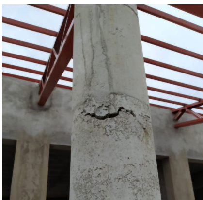
Figura 12. Falhas na concretagem do pilar.
