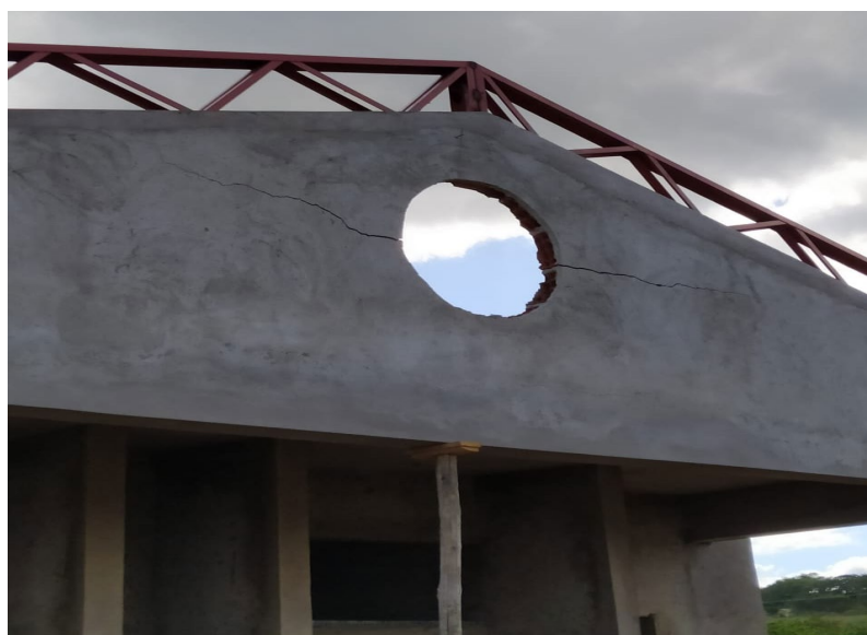
Figura 9. Fissura localizada na alvenaria da fachada.
