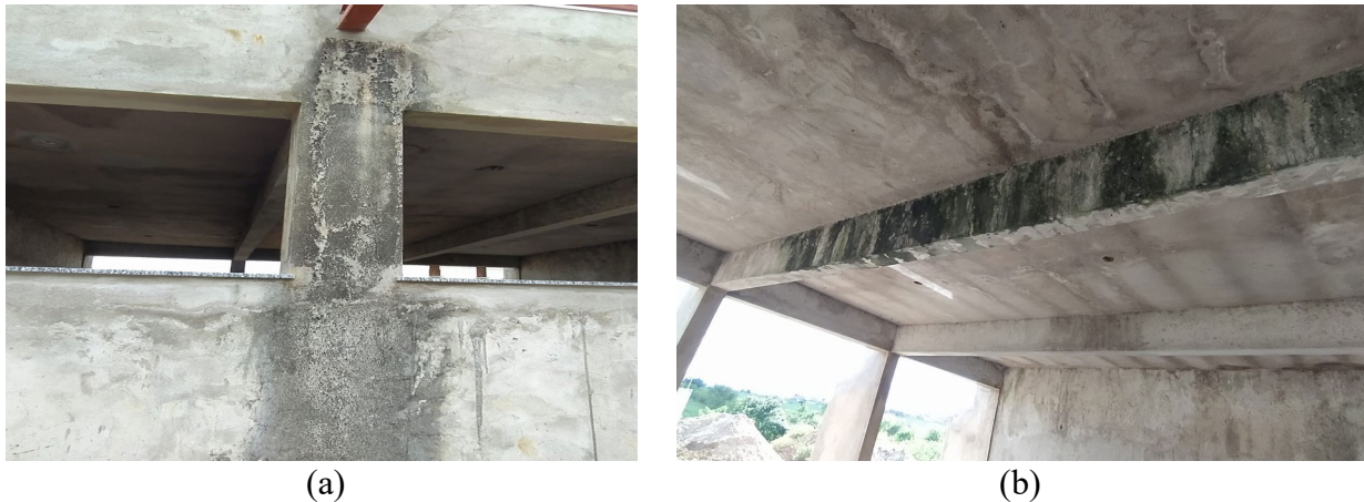
Figura 10. Mancha de umidade (a) Viga com manchas de umidade, bolor e exsudação de hidróxido de cálcio (b).
