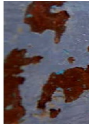
Figura 3 – Corrosão em Painel de chapas delgadas de aço
