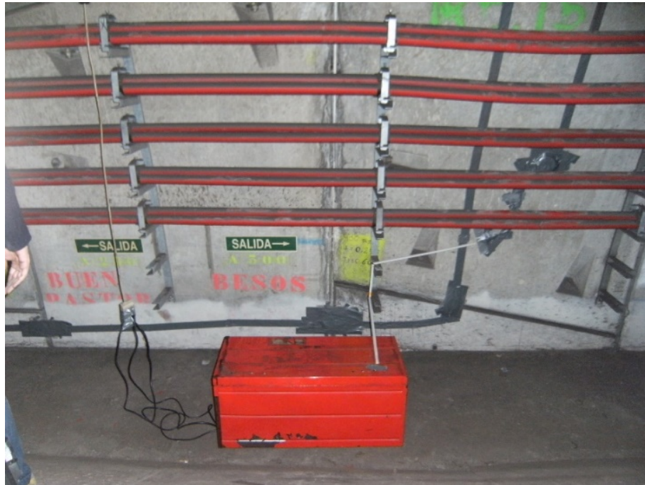
Figura 10. Instalación equipo de lectura de la fibra en lugar protegido.
