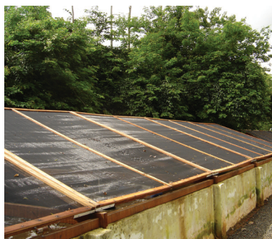
Figura 2 – Tanques de aeração I e II
