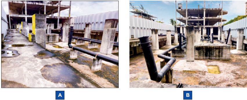
FIGURA 17 MANCHAS DE UMIDADE NO SUBSOLO DO BLOCO B. (A) E (B) ESTRUTURA E PISO
