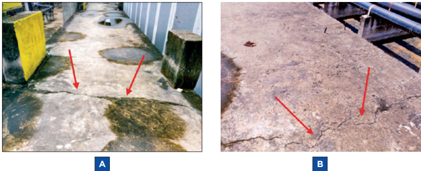
FIGURA 18 (A) E (B) FISSURAS NO PISO DO SUBSOLO DO BLOCO B
