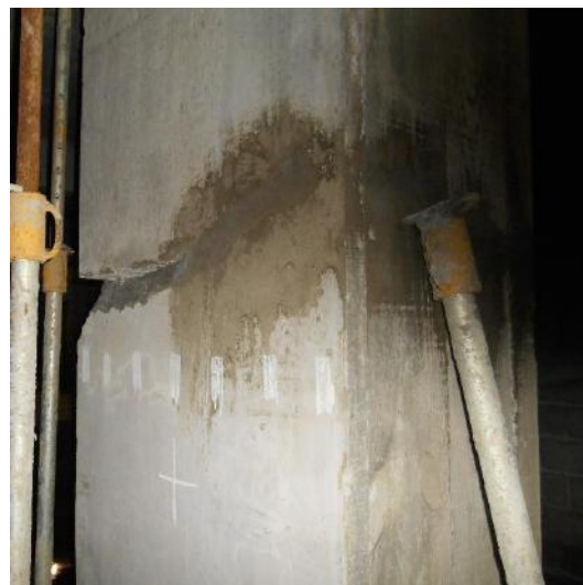
Figura 6: Comprometimento do cobrimento do pilar 24 (P24) (Fonte: da autora)
