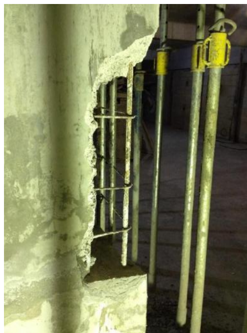
Figura 8: P24, sem apresentar flambagem aparente na armadura (fonte: da autora)
