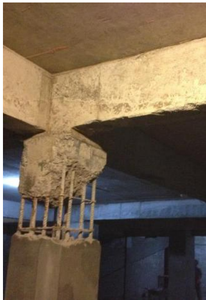
Figura 3: Armadura exposta do pilar 16 (P16) (Fonte: da autora)
