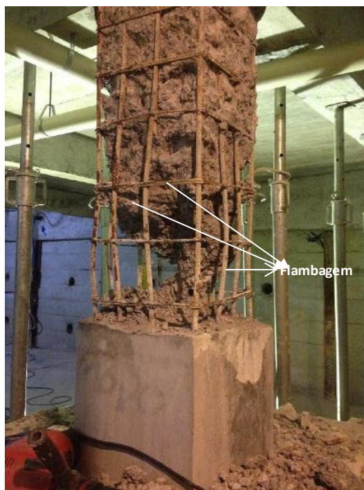
Figura 9: P6, apresentação de flambagem da armadura (fonte: da autora)
