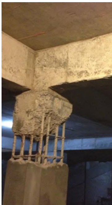
Figura 7: P16, sem apresentar flambagem aparente na armadura (fonte: da autora)
