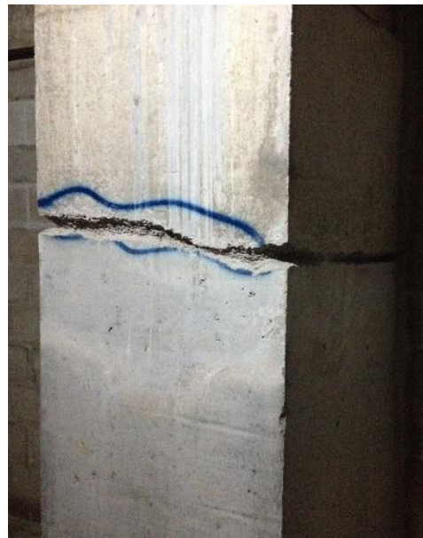
Figura 4: Comprometimento do cobrimento do pilar 22 (P22) (Fonte: da autora)
