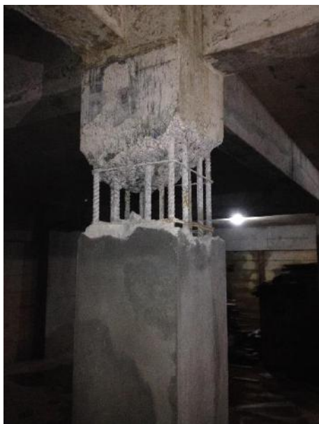
Figura 1: Armadura exposta do pilar 6 (P6). (Fonte: da autora)
