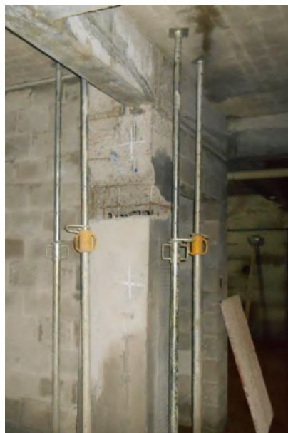
Figura 2: Armadura exposta do pilar 12 (P12). (Fonte: da autora)
