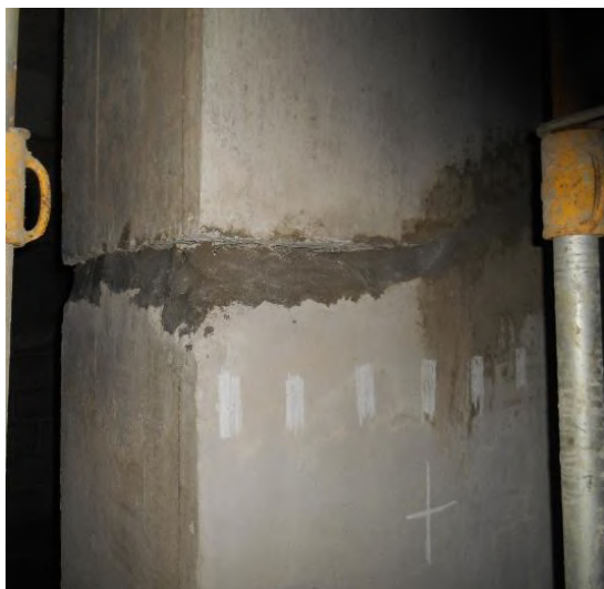
Figura 5: Comprometimento do cobrimento do pilar 23 (P23) (Fonte: da autora)
