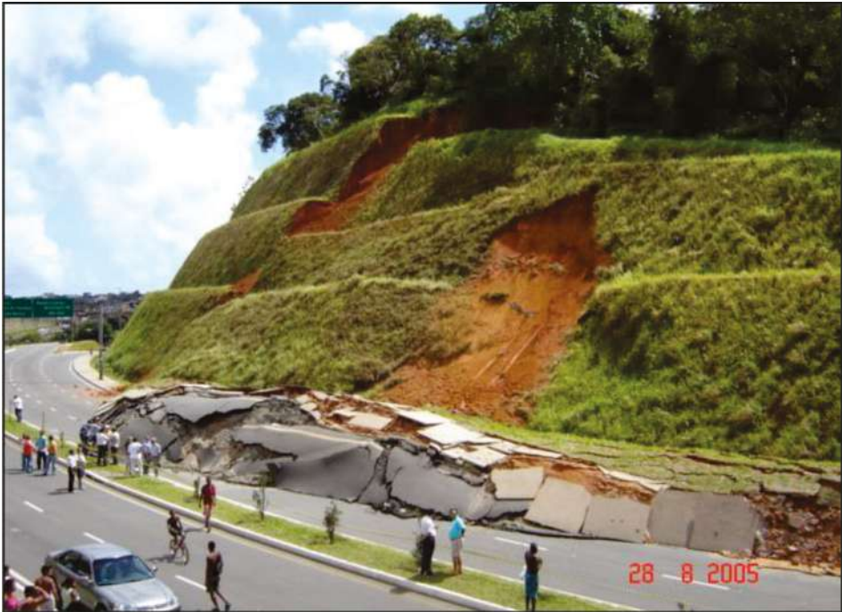
Figura 7 – Ruptura de talude em Salvador (imagem cedida por Luis Edmundo Prado de Campos)
