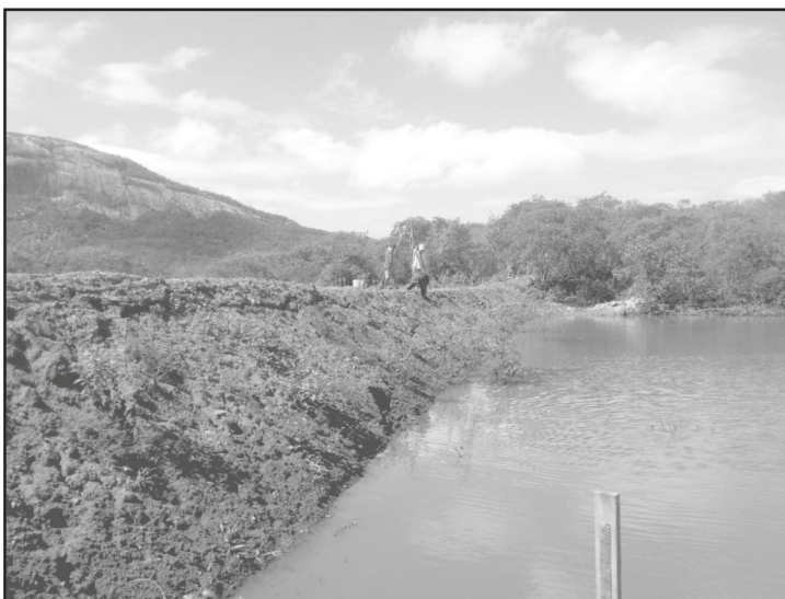
Figura 13 – Rachaduras no talude provocada pelo colapso
