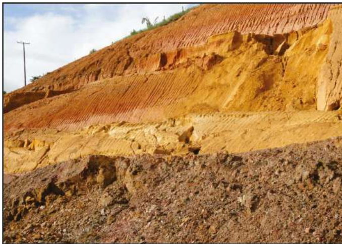
Figura 8 – Perfil de solo residual de rocha sedimentar, Salvador - BA. Foto: Moacyr Schwab.
